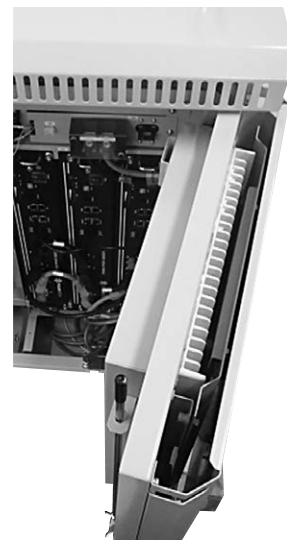
写真3 UPSユニット (扉部)
